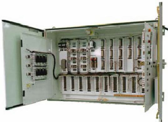
Figura 3.3.9 Gabinete de control.
