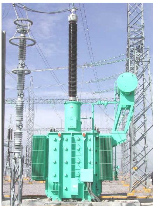
Figura 2.6 Reactor monofásico sumergido en aceite.
